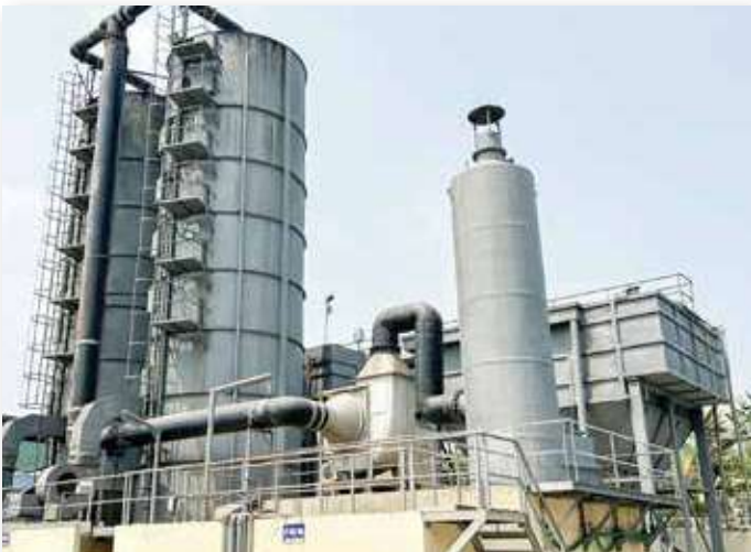
Hệ thống xử lý khí amoniac phát sinh trong quá trình xử lý nước rỉ rác
