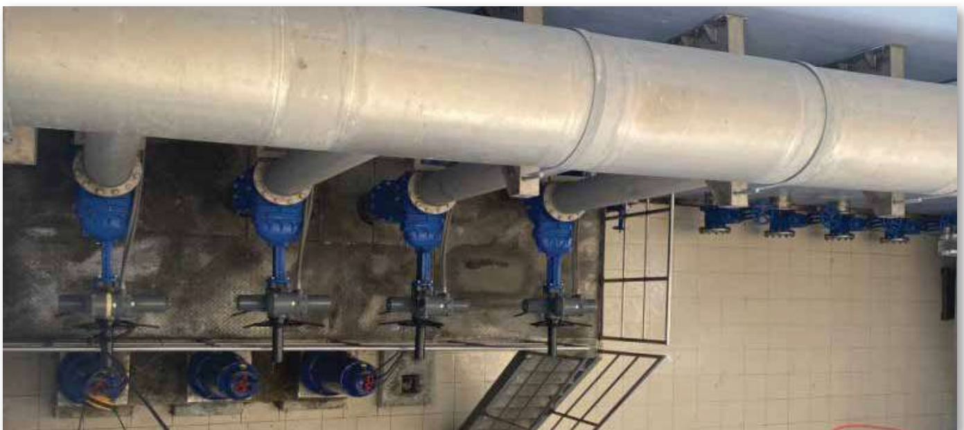
Hệ thống bơm chuyên dụng bơm nước thải lên bể lắng
