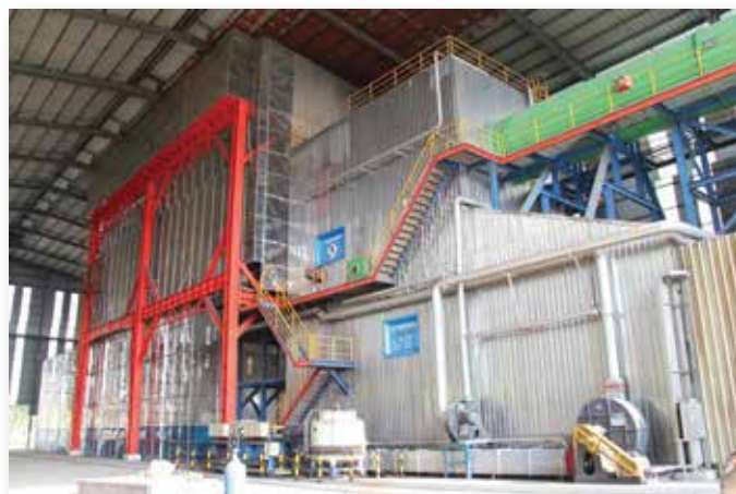
Lò đốt rác 200 tấn/ngày thu hồi nhiệt phát điện 5MW.
