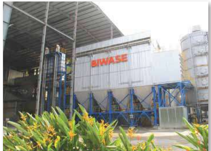
Hệ thống lọc bụi túi vải và xử lý khí thải
