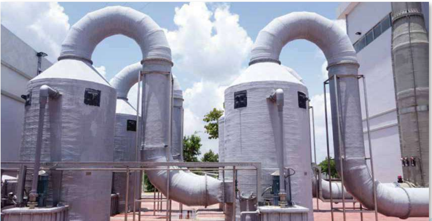
Hệ thống xử lý mùi
