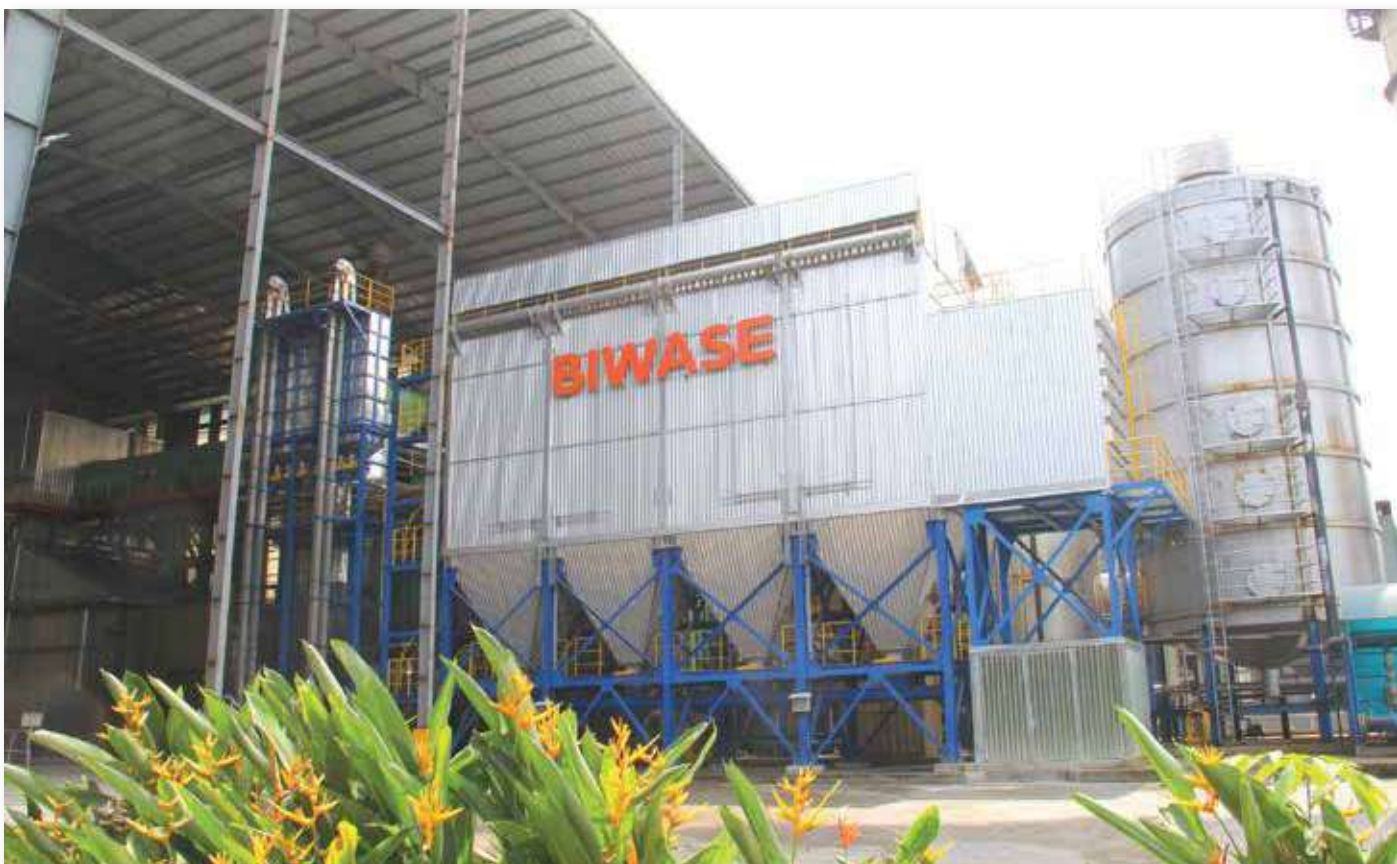
Hệ thống lọc bụi túi vải và xử lý khí thải
